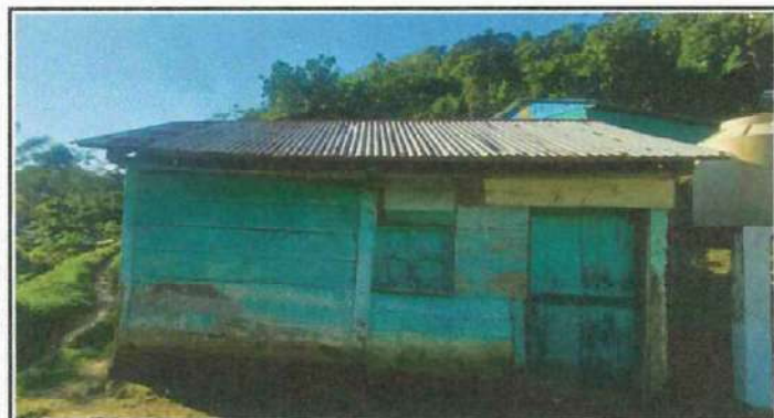
Foto 3: En esta fotografía se observa la infraestructura de la cocina, es urgente que se remodele para la alimentación de los niños.
