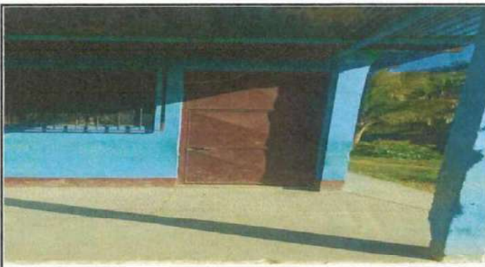
Foto 4: En esta fotografía se observa una de las dos puertas que necesita su reparación.
